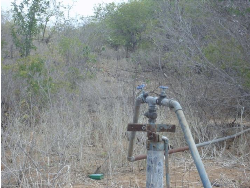
Poço Tubular, Prof.80m; Vazão 26,40 m 3 /h; STD 1.354 mg/l; Anfibolito; Faz. Recanto Tricolor, Uauá
